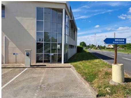
Borne électrique sur le parking de WESER à Mazières-de-Touraine
